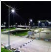
■ 室外照明系统
