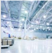
■ 室内照明系统
