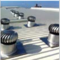
■ 管道通风屋顶涡轮通风
