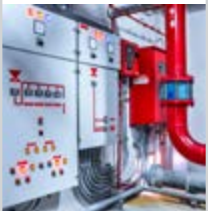
■ 消防主控系统
